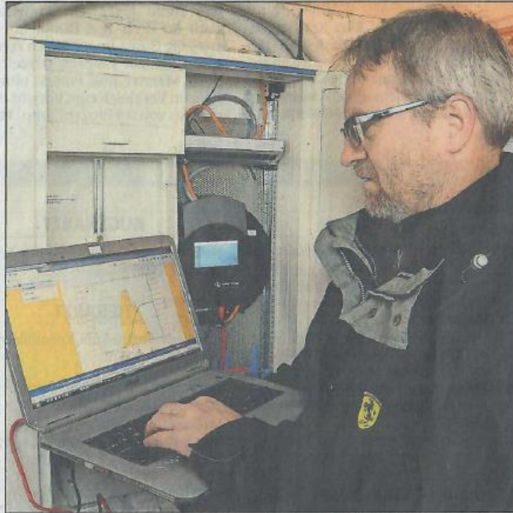
Installateur Jochen Marwede checkt die Daten, die die Photovoltaikanlage in den Zählerkasten im Keller schickt.
