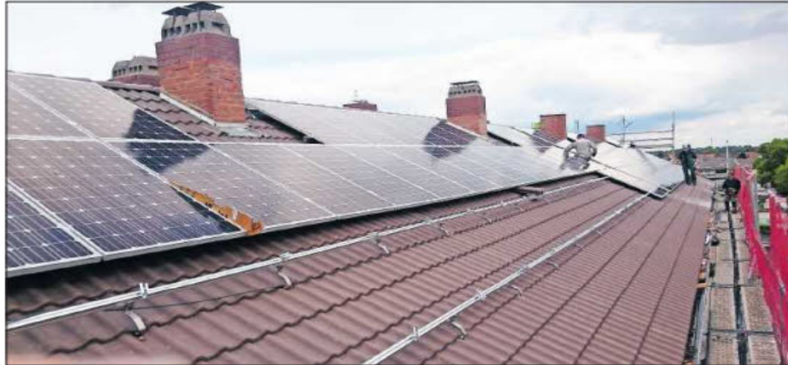
70.000 Kilowattstunden Strom können mit der neuen Anlage auf den WBG-Dächern in der Brachweilerhofstraße 86, 86b und 88a erzeugt werden. FOTO: BEGIN/FREI
